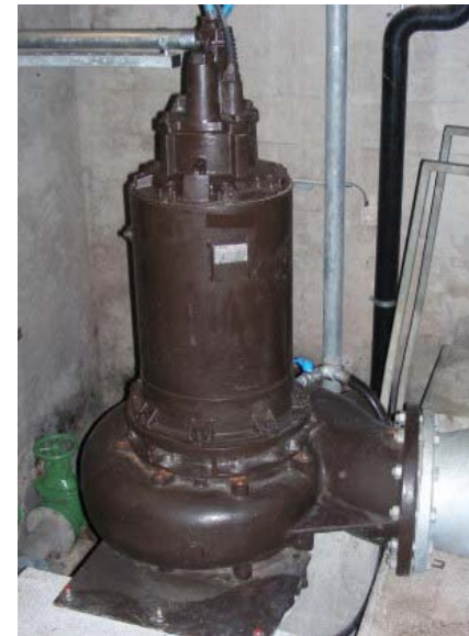
Pumpe Rohwasserzulauf (1 von 4)
