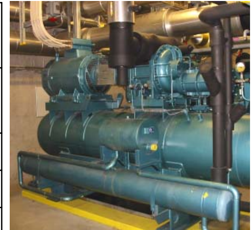
Kälteerzeugung für Klimaanlage
